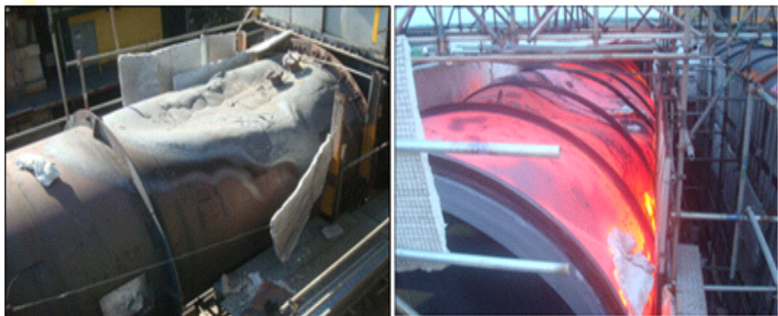
Figura 3: Colapso do duto - queda de todos os refratários.
