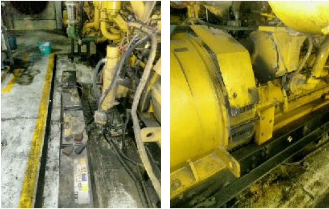
Figura 3 – Falta de Manutenção Proativa em Sala de Máquinas e Equipamento.
